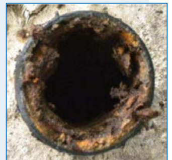
Figura 2. Imágenes que muestran la sección transversal de tuberías que contienen biofilm.
